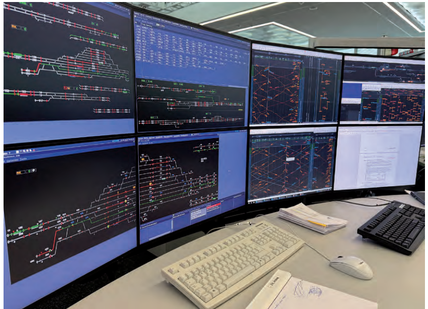
Arbeitsplatz eines Zugverkehrsleiters in der BZ Mitte.
